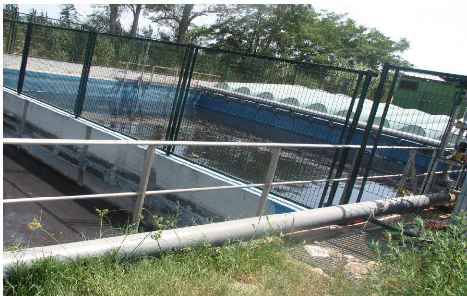
Bể lắng và bể lắng bùn sinh học
