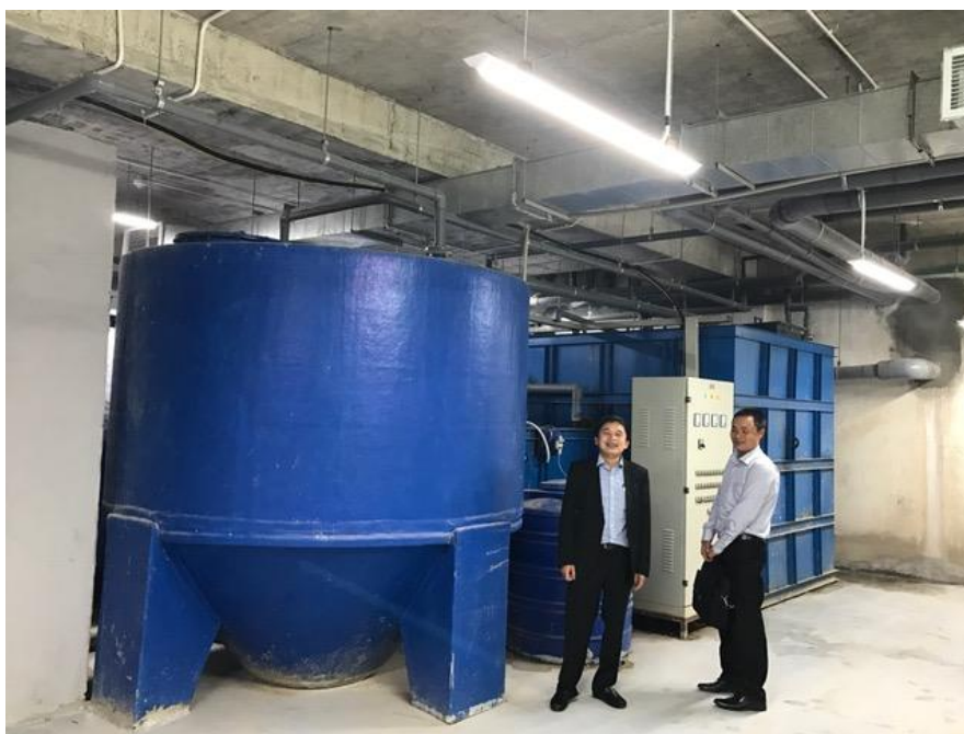
Trạm Xử Lý Nước Thải 20m 3 /h Khu điều dưỡng cán bộ Hà Nội tại Đồ Sơn Hải Phòng
